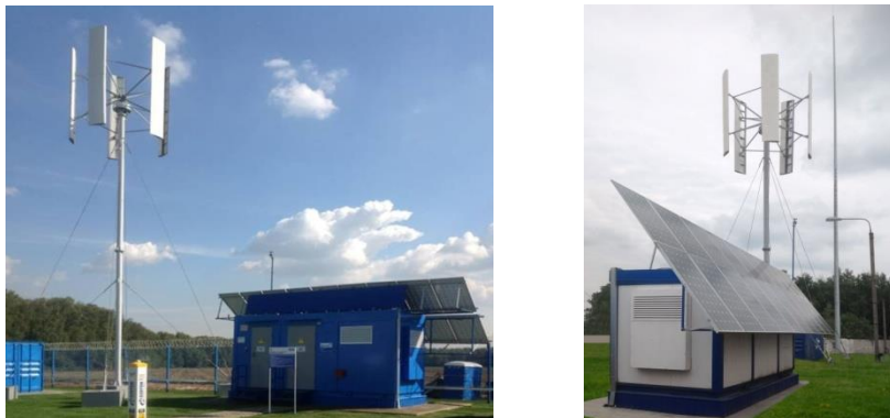
Рис. 6. Головной образец контейнерной энергоустановки БКЭУ-ВСМ/ДГА на площадке КРП-16 в ООО «Газпром трансгаз Москва»
